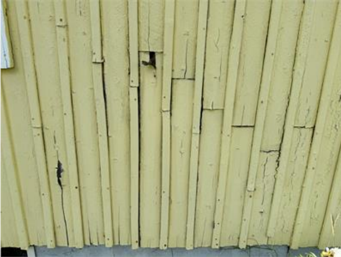
Rötskador förekommer i fasaden.
