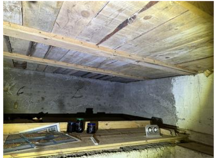
Mikrobiell påväxt på bjälklagets undersida i matkällare.
