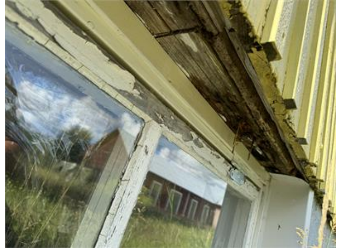
Rötskador i vägg över källarfönster.
