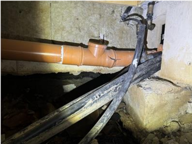
Avloppsrör som spruckit i krypgrunden.
