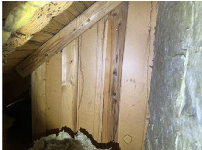
Rinnmärken på takkupans gipsskiva, bild tagen från sidovind 2.
