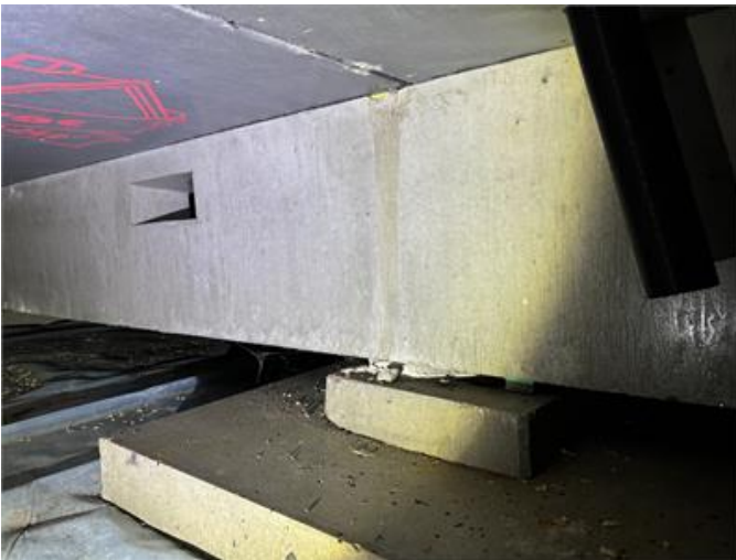
Kondensutfällning på betongbalk i kryppgrunden.
