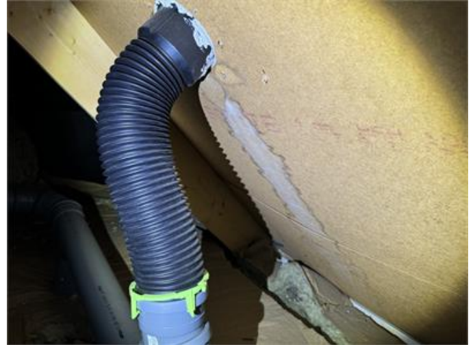
Fuktgenomslag på underlagstak under avluftning, bild tagen på sidovind.
