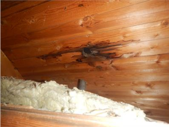
Fuktfläck vid tidigare genomföring för expansionskärn vind.
