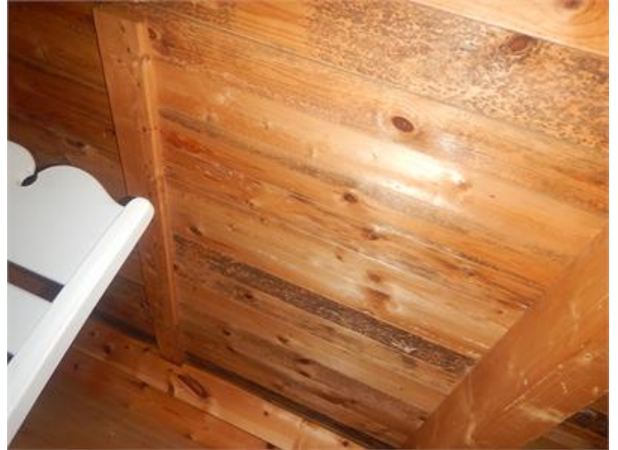
Mikrobiell påväxt på underlagstak vind.
