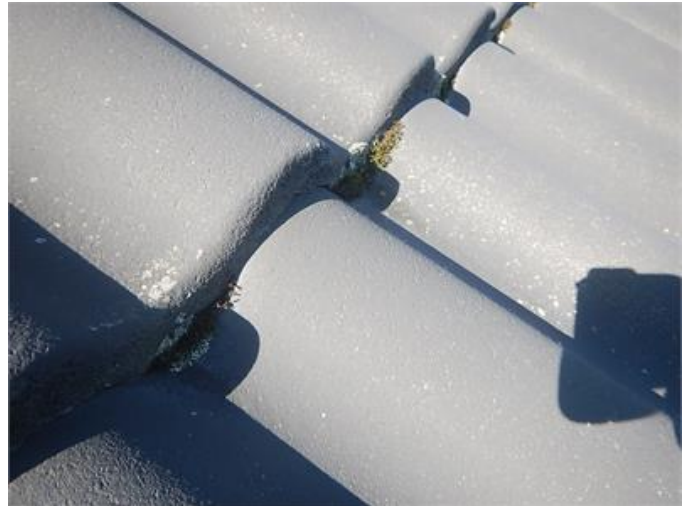
Mossa på takpannor.
