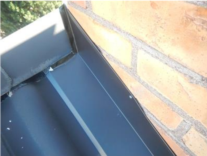
Otätthet mellan murstock skorstensbeslag.
