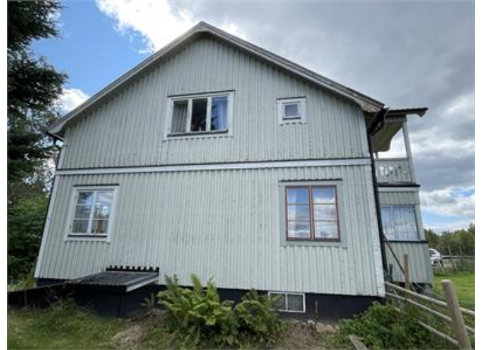
Fasad och trädetaljer på fasad, entré och tak har målningsbehov.
