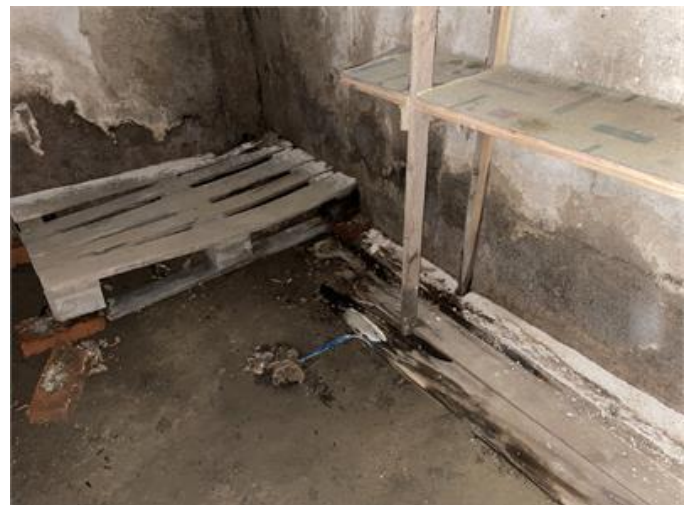
Rötskador och mikrobiell påväxt förekommer på trädetaljer i matkällaren.
