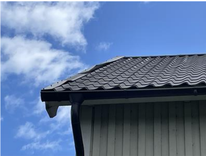
Plåtbeslag är i behov av justering lokalt.
