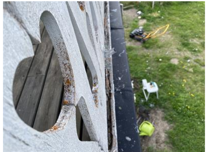
Rötskador noteras lokalt på trädetaljer balkong.
