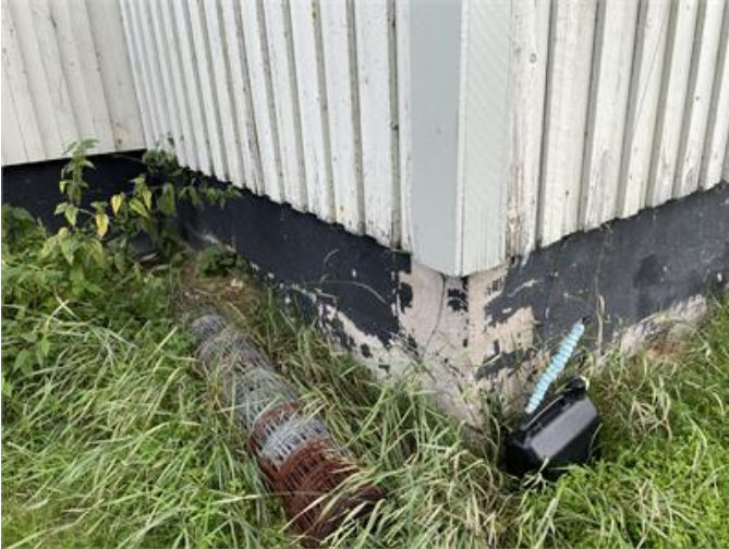
Puts-, färgsläpp och sprickor förekommer på sockel.
