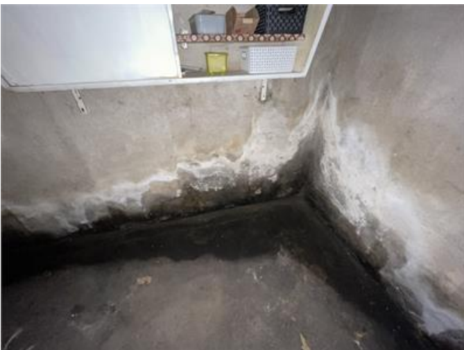
En förhöjd fuktighet i betongplatta samt motfyllda källarväggar är att förväntas i en äldre källare.
