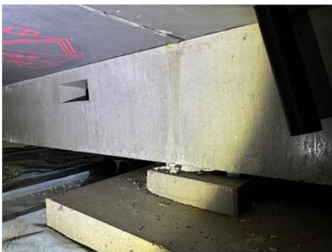
Kondensutfällning på betongbalk i kryppgrunden.
