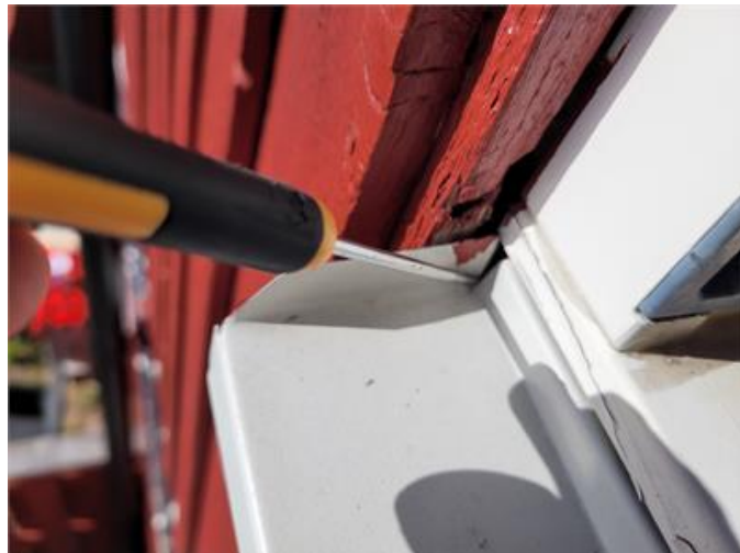
Otätt uppvik på fönsterbleck.
