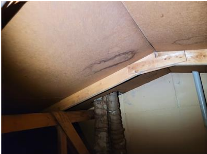
Fuktfläckar på underlagstak
