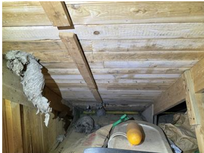
Mikrobiell påväxt på vindens underlagstak.
