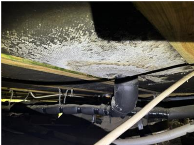
Fuktskadad blindbottensskiva under duschutrymme.
