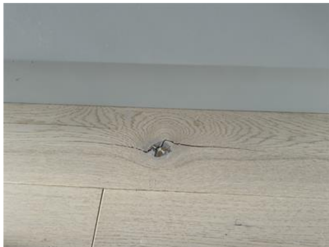
Spricka i parkettgolvet.
