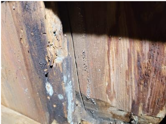
Mikrobiell påväxt samt missfärgningar på underlagstak
