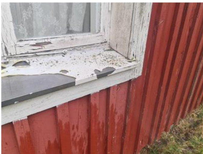
Fasad och Fönster, delvis i behov av byte.
