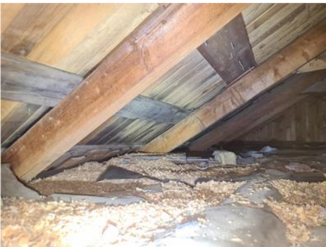
Nockvind, mörk mikrobiell påväxt i underlagstaket ner mot takfoten.
