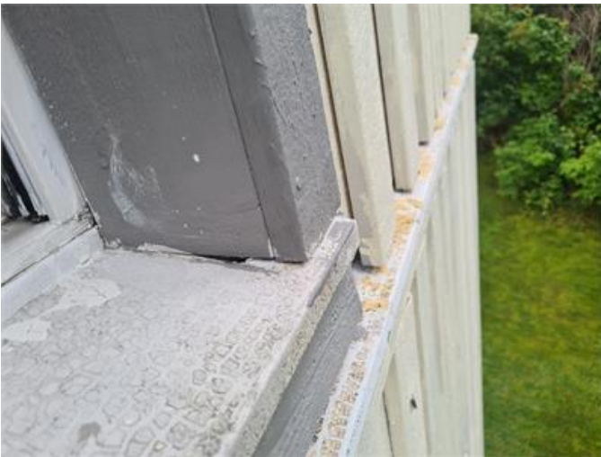
Fasad, otäthet vid fönsterbleck.
