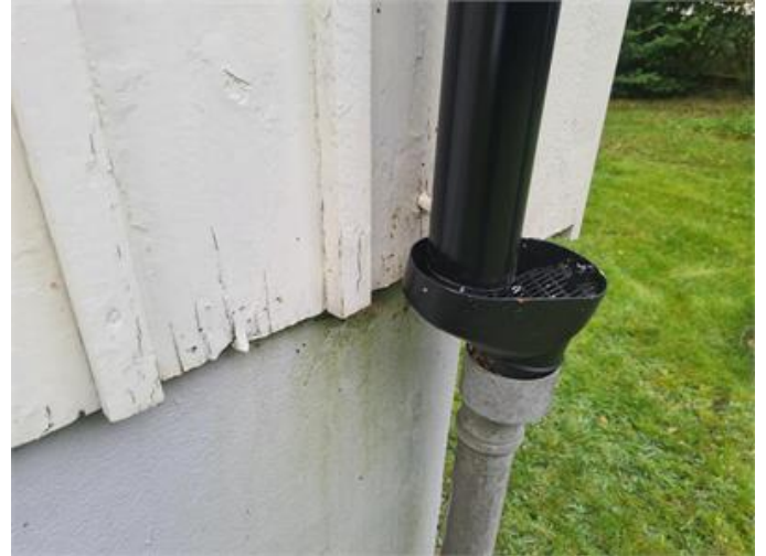
Fasad, rötskador där lövsil är placerad vid fasad, markrör har mindre dimension.
