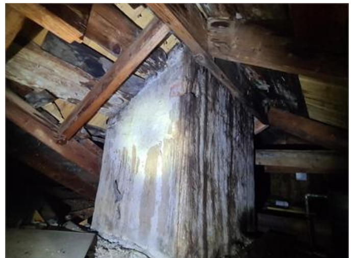
Nockvind, fuktanvisningar/rinnmärken på och runt murstock.
