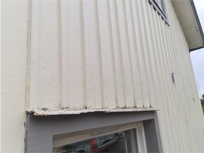
Fasad, äldre med sprickor och färgsläpp, droppspalt mot överbleck finns ej.
