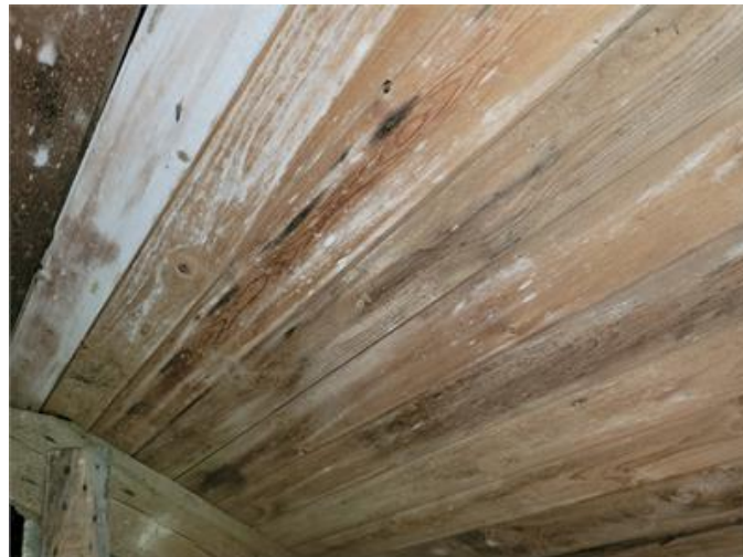
Mikrobiell påväxt på underlagstak
