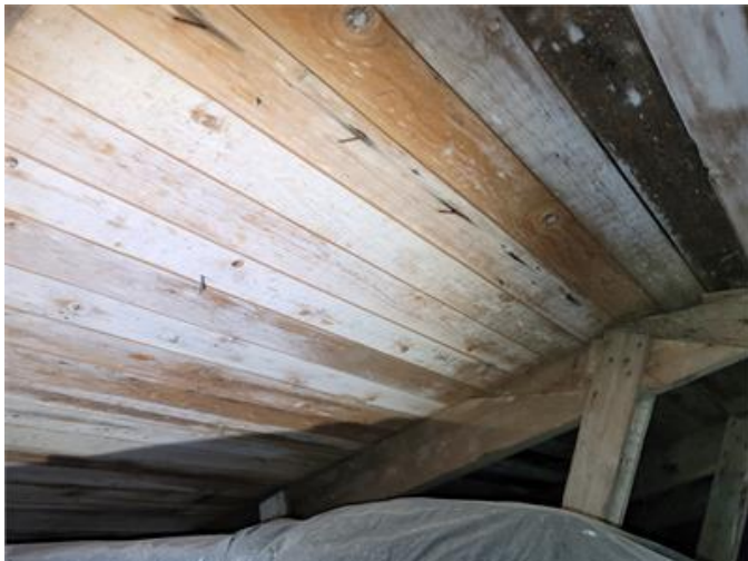
Mikrobiell påväxt på underlagstak
