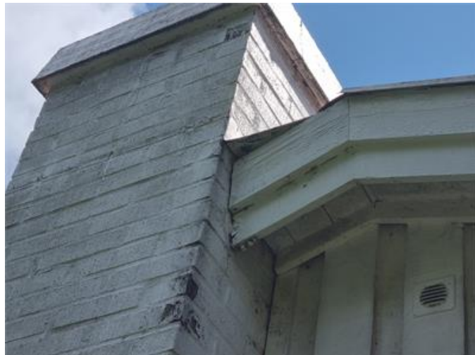
Bilden exempel på rötskador i vindskiva.
