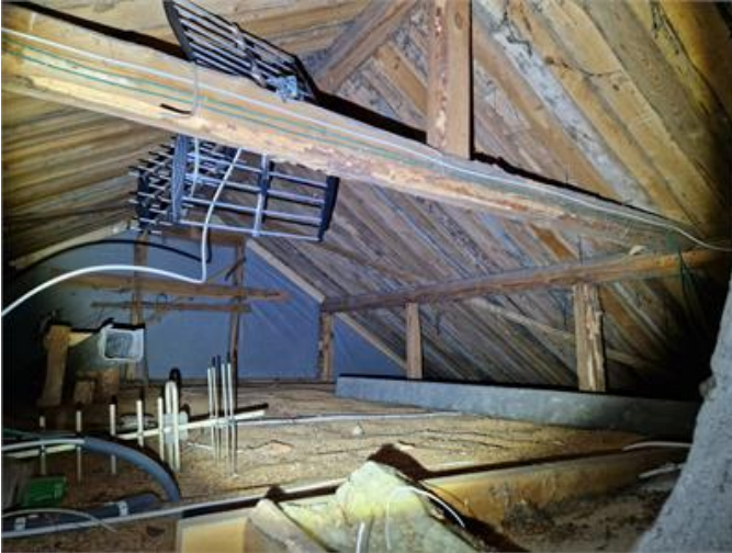
Vind: Fuktfläckar/Missfärgningar förekommer i underlagstak.
