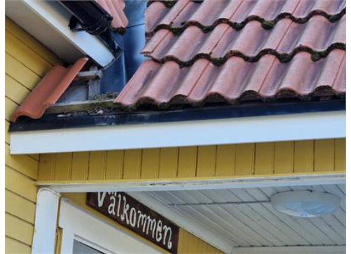
Tak: Läkt monterad i rännal - bör kontrolleras och åtgärdas.
