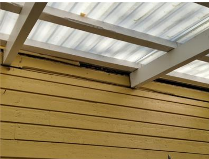
Altan: Otätheter och förskjutningar förekommer i fasadpanel i anslutning till altantak.
