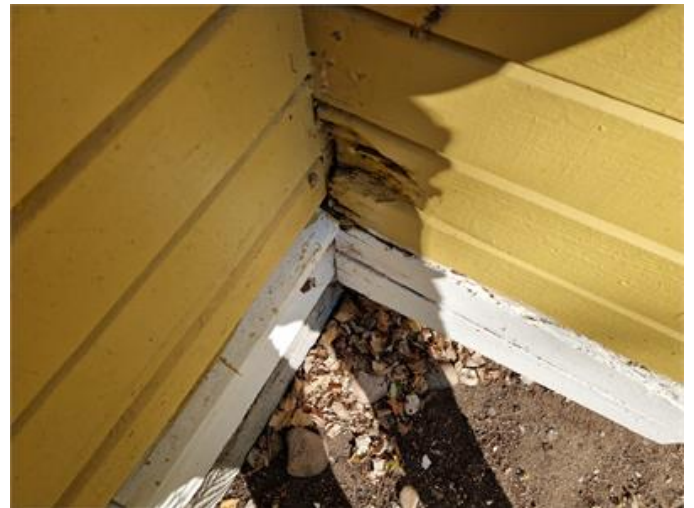
Fasad: Lokala rötskador förekommer i fasad
