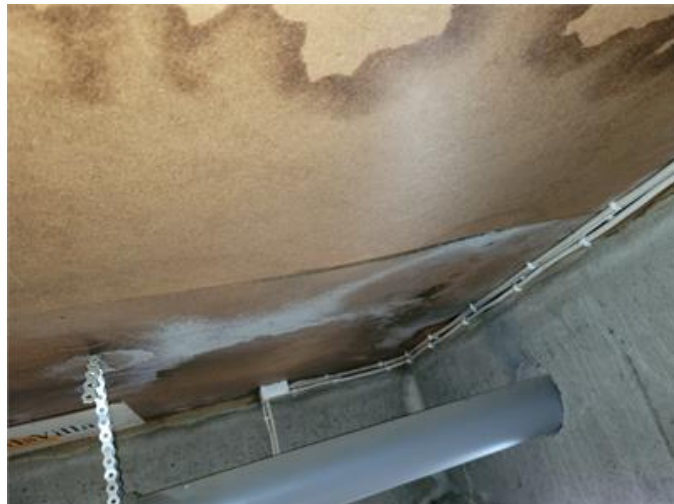
Fuktfläckar på blindbotten.
