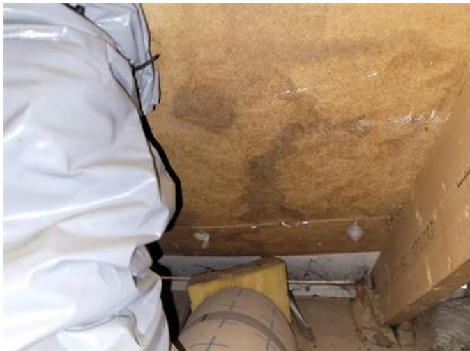
Fuktfläckar på underlagstak av board
