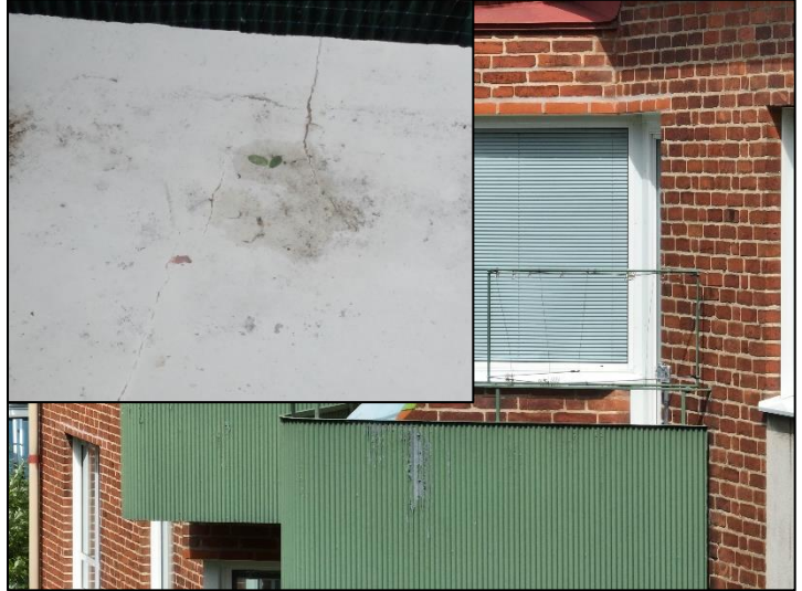
Sprickor ovansida balkongplatta samt färgflagningar räcke
