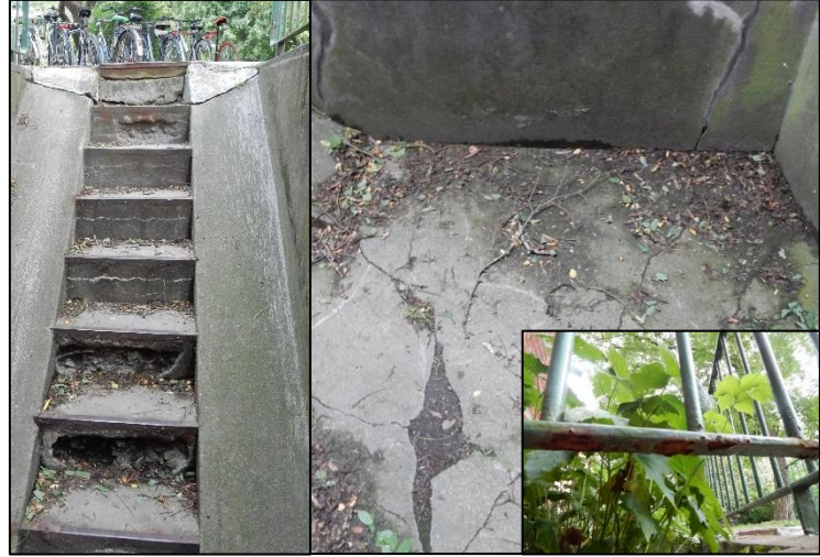
Sprickor och betongsläpp i källartrappa samt rostskador på räcke
