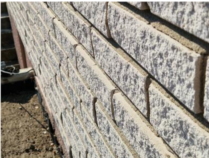
Fasad: Sprickor och förskjutningar förekommer i tegelfasad.
