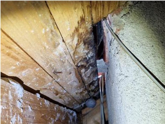
Vind: Fuktfläckar förekommer i underlagstak i anslutning till skorsten.
