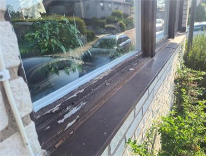
Fönster, äldre och framförallt vardagsrumsfönster är i dåligt skick
