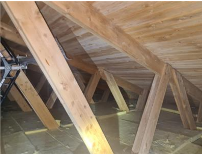
Nockvind, ljus mikrobiell påväxt på underlagstaket.
