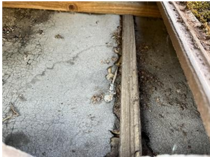
Trasig takpapp under takpanna.
