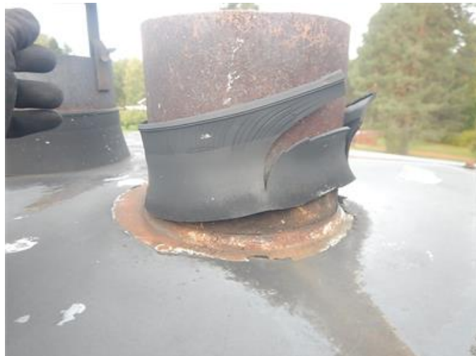
Manschett till skorstenen som torkat sönder.
