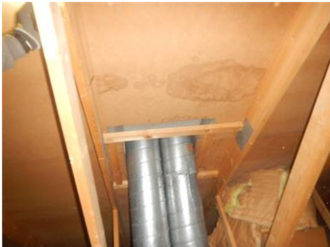
Fuktfleck på underlagstak av masonit vind.
