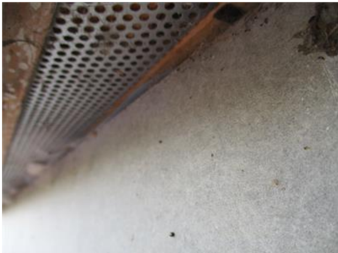
Obehandlad syll på fuktskydd mot betongplattan
