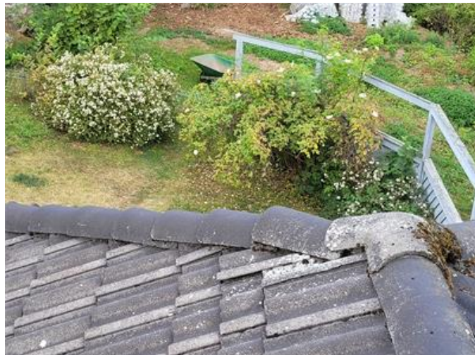
Takpannor med justeringsbehov.
