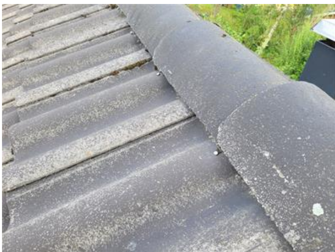
Synliga infästningshål på takpannor
