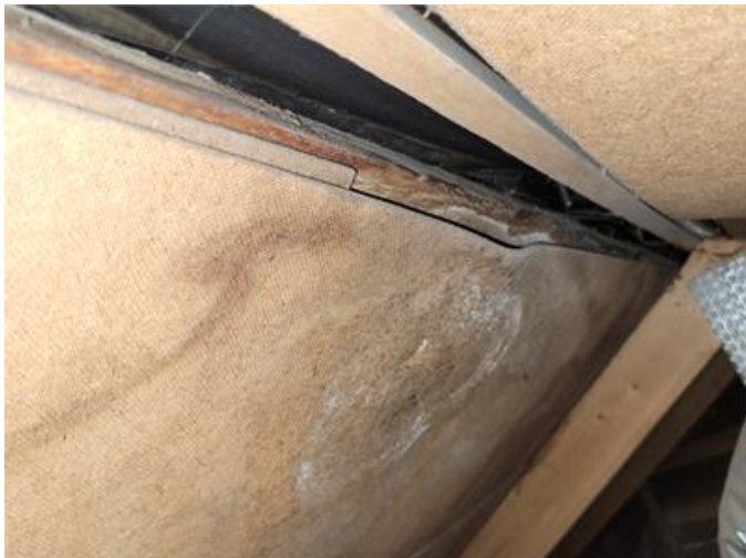
Fuktfläckar på underlagstak
