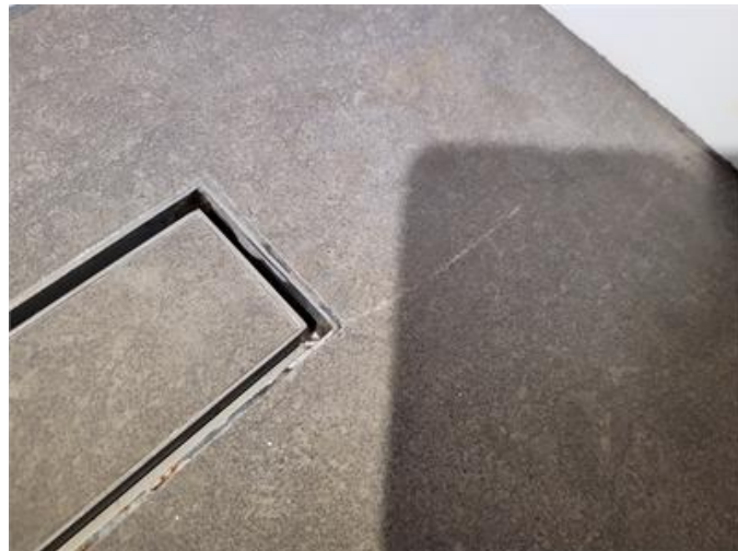
Spricka i klinkergolv i dusch
