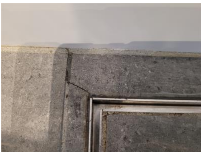
Spricka i klinkergolv i badrum
