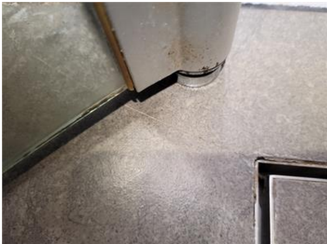
Spricka i klinkergolv i dusch
