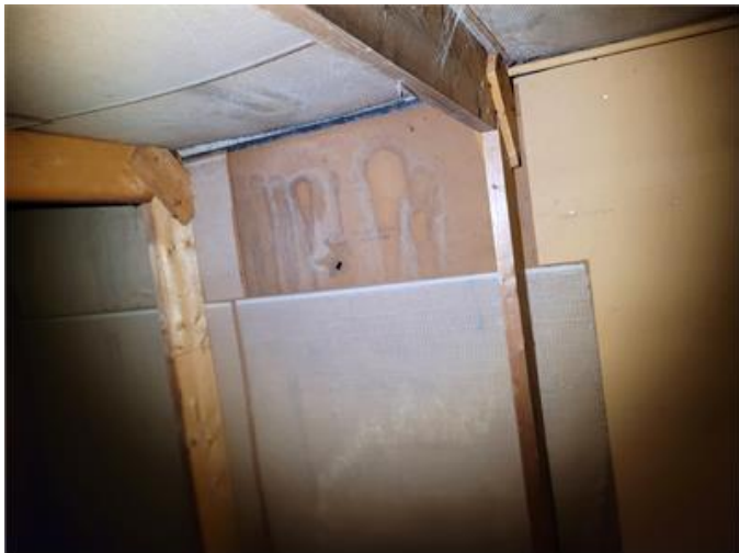
Fuktfläckar på underlagstak
