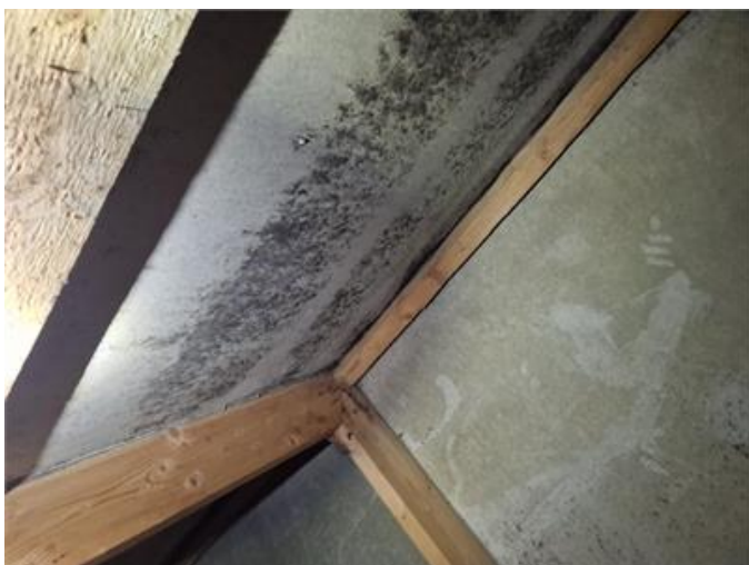
Mikrobiell påväxt på underlagstak/vind
