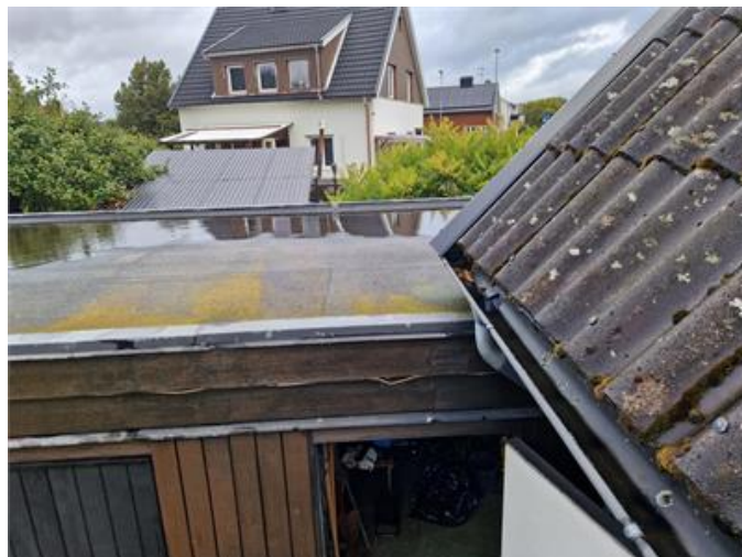
Vy på garagetak med vattensamling
