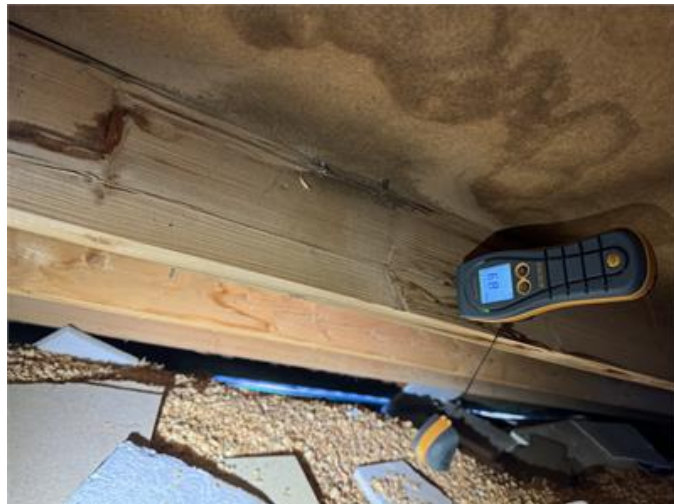
Fuktkvotsmätning i takstol på vind.
