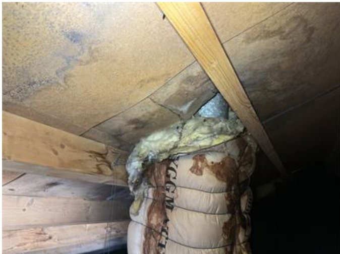
Fuktfäckor på vindens underlagstak.
