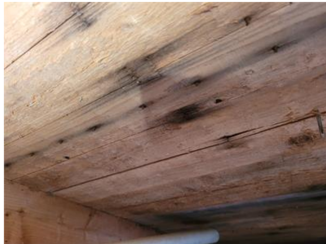
Missfärgningar på underlagstak
