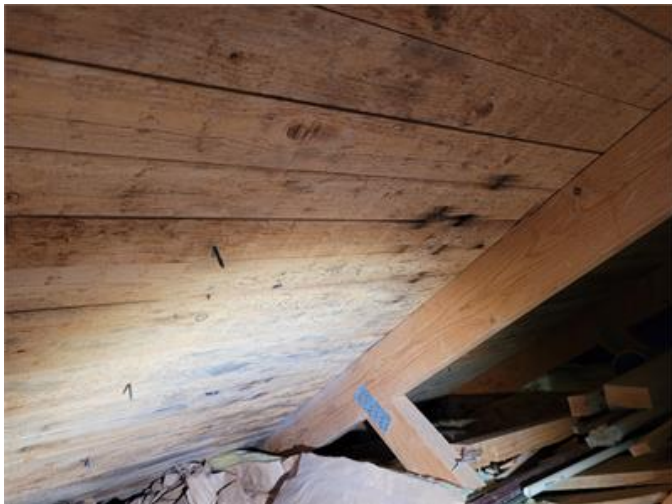
Mikrobiell påväxt på underlagstak.
