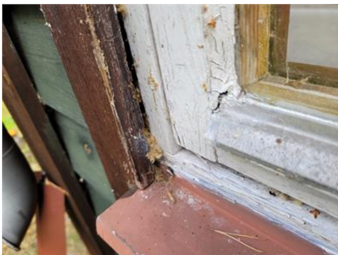
Otättheter runt fönster.
