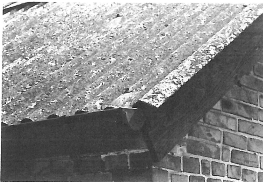
Fig 37. ... ny taktäckning av eternit.
