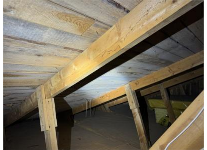
Bild visar mikrobiell påväxt mot underlagstaket.
