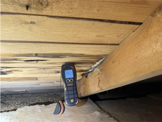
Takläckage förekommer lokalt.
