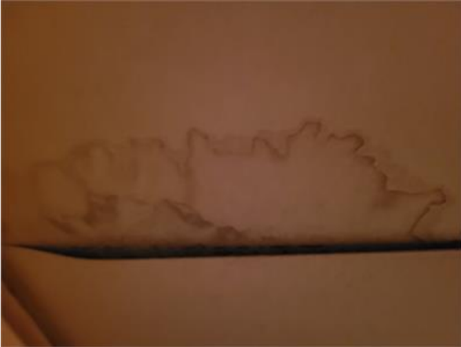
Fuktfläckar på underlagstak
