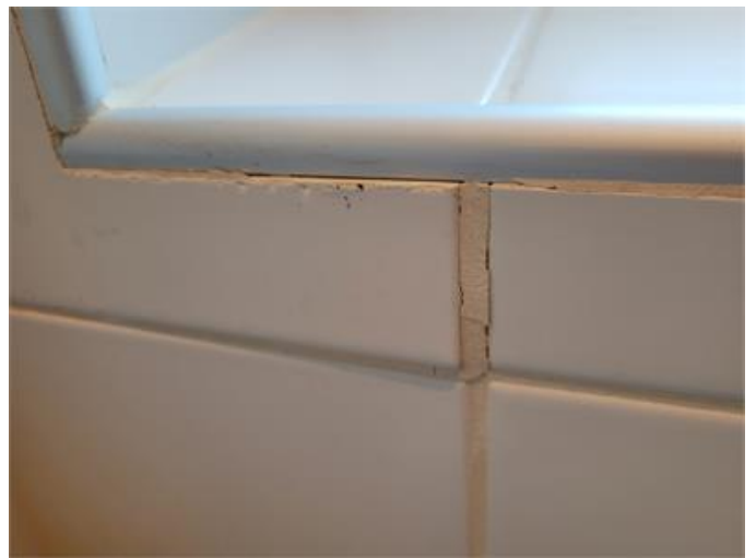
Spricka i kakelfog.
