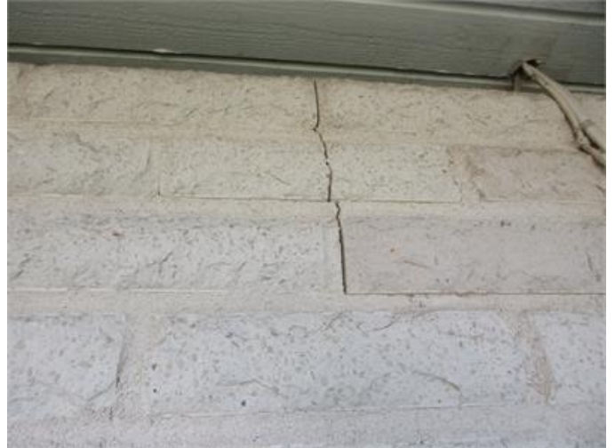
Spricka i fasadstenen
