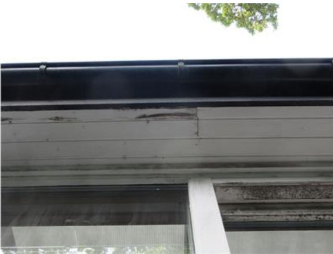
Rötskada i takutskjut
