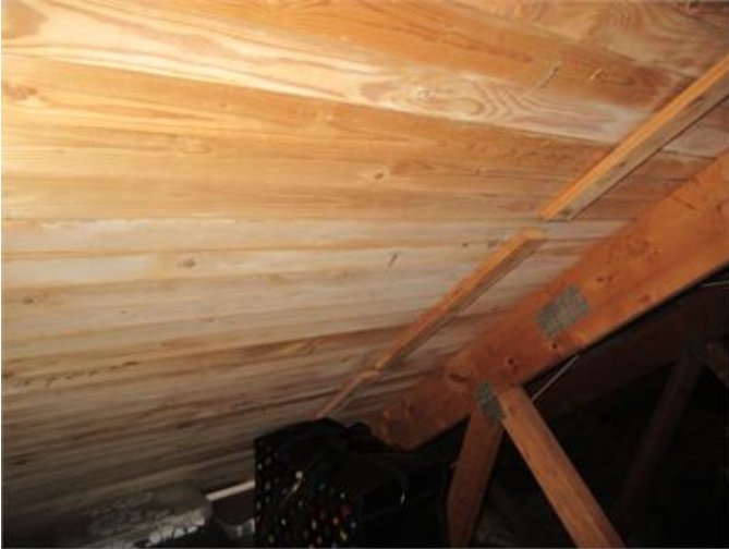
Mikrobiell påväxt på insida yttertaket på vinden
