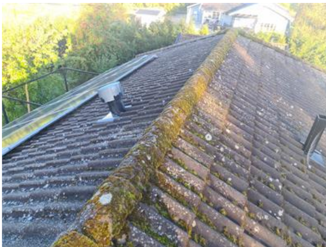
Tak, översiktsbild, äldre med mossor och några trasiga pannor.
