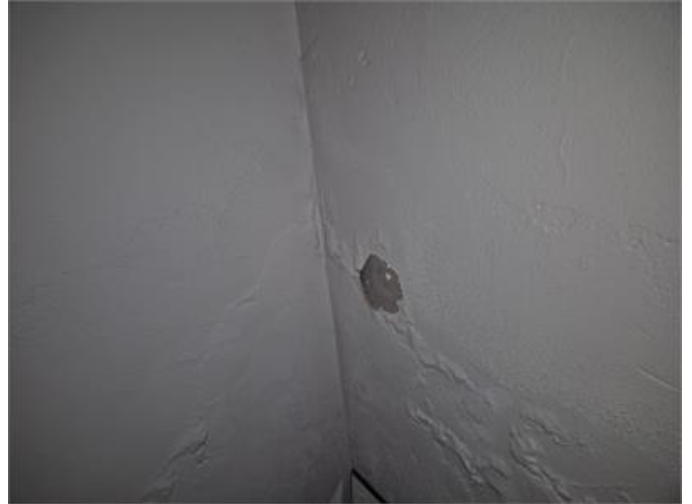
Puts/färgsläpp och hög fukt mot källarvägg.
