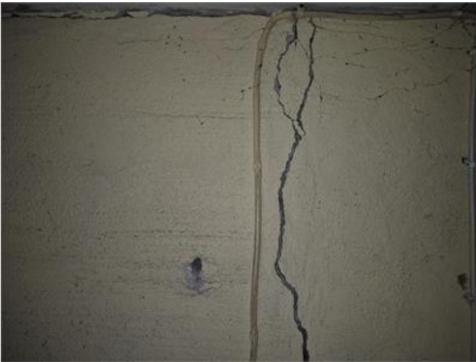
Sättspricka i garagevägg.
