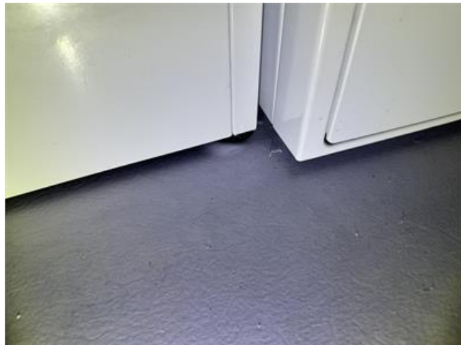
Mindre mattsläpp vid tvättbänkens ben i tvättstuga.
