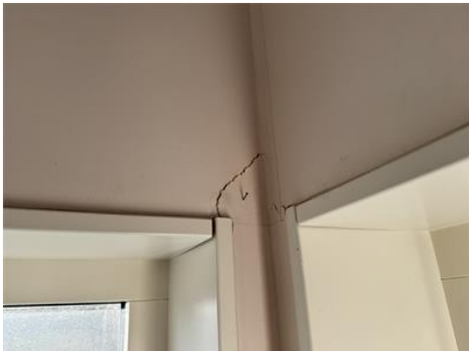
Spricka i vägg vid fönster.
