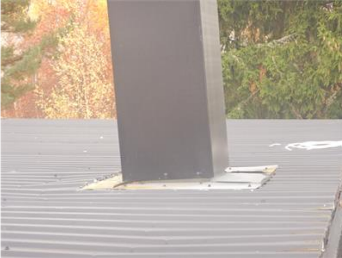
Bristfälligt utförande av plåtbeslag.
