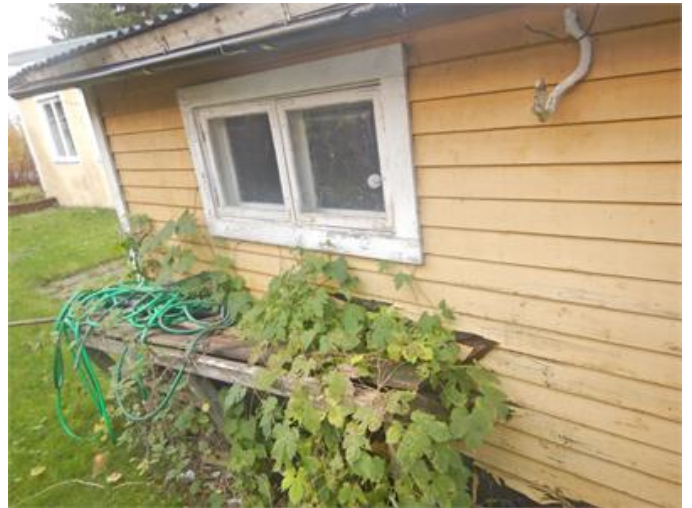
Rötskador i panel på yttervägg vid förråd.
