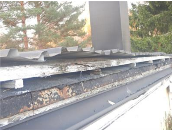
Rötskadad läkt nedanför skorsten
