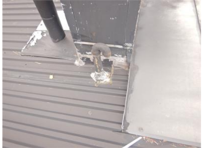
Bristfälligt utförande av genomföring.
