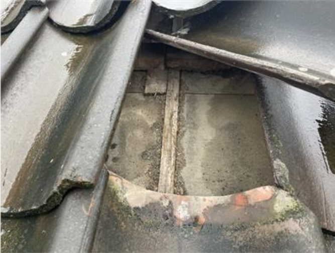
Ålderstigen underlagspapp och läkt till yttertaket.
