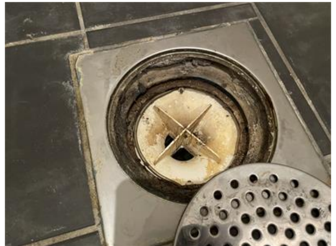
Manschett i golvbrunnar bedöms ej vara korrekt skuren (synlig under klämring).
