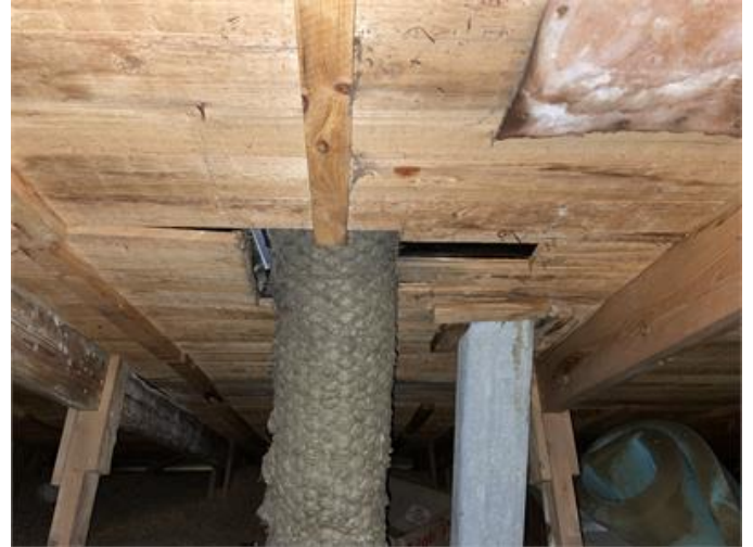
Lokala fuktfläckar förekommer till insida yttertak vindsutrymme främst vid genomföringar.
