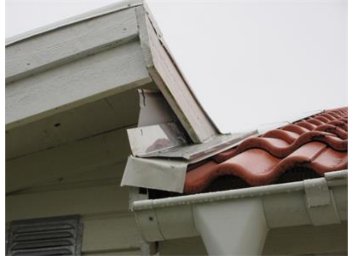
Bristfälligt montage av plåtar på yttertaket
