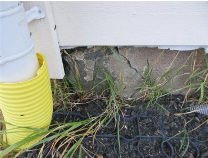
Spricka i sockeln
