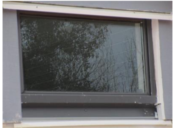
Fönster som är installerat upp och ner
