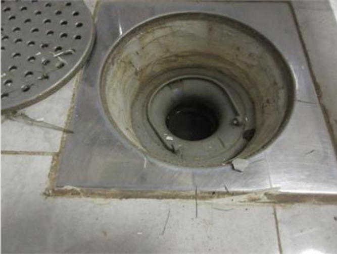
Golvbrunn utan synlig brunnsmanschett
