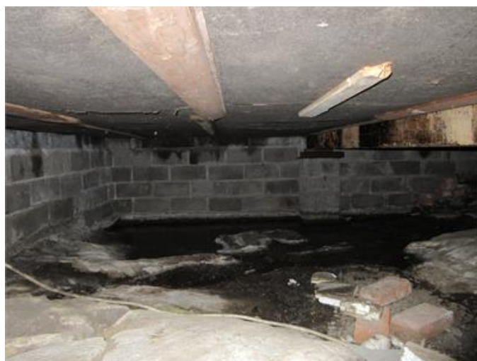
Fuktgenomslag på grundmurar samt vattenansamlingar på mark
