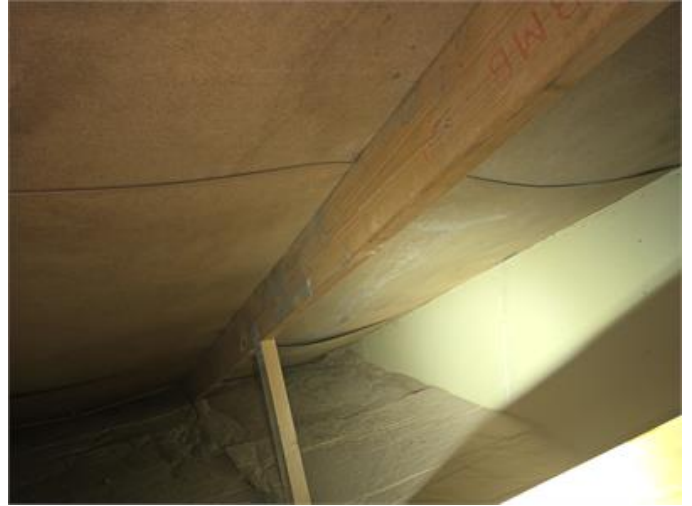
Exempelbild, fuktfläckar i underlagstak.
