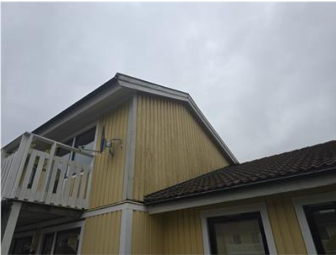
Exempelbild, målning/underhållsbehov och rötskador fasad/snickerier.
