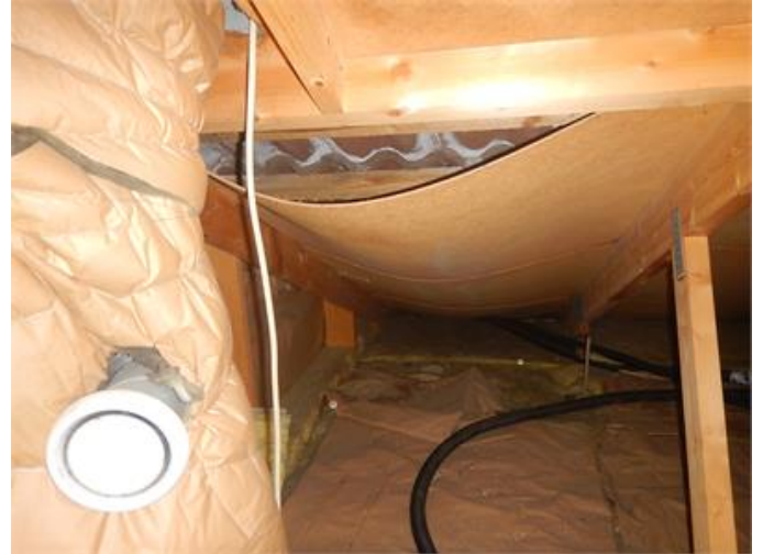
Underlagsboard som släppt i infästning vind.
