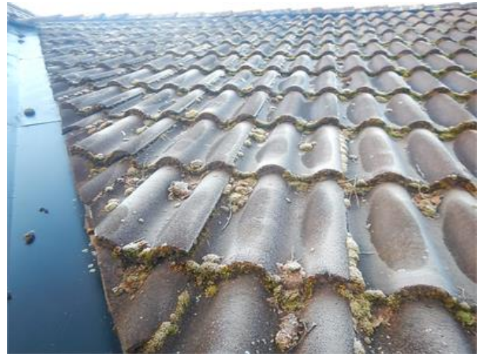
Mossa på takpannor.
