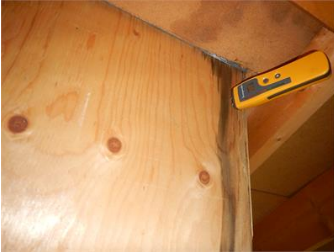
Fuktpåverkan på inbyggnad till tidigare skorsten vind.
