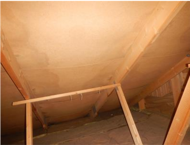
Fuktfläckar på underlagsboard vind.
