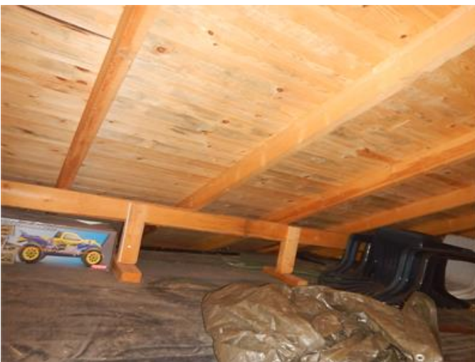
Mikrobiell påväxt på underlagstak vind garage.
