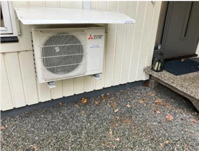
Luftvärmepumpen vid fasaden
