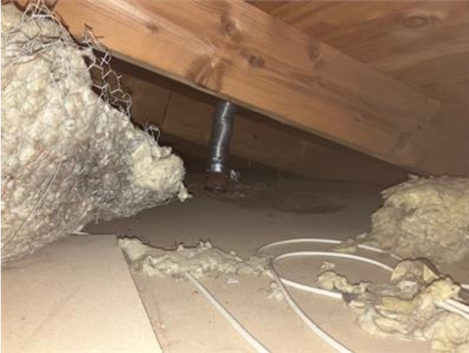
Rostigt rör samt fuktfläck på vinden
