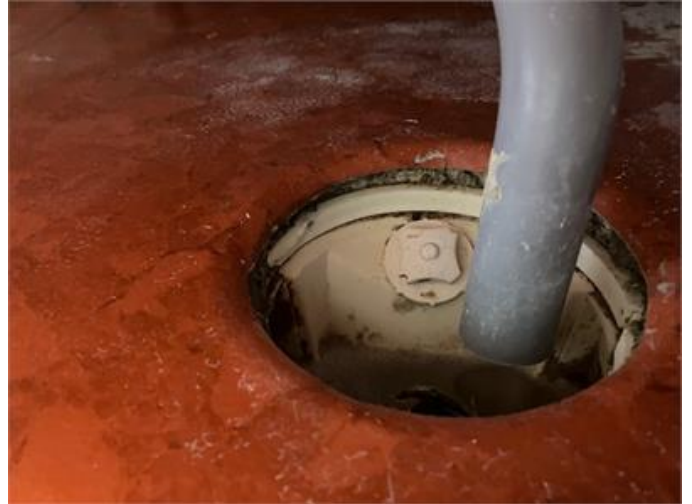
Plastmatta på golvet som släppt runt golvbrunnen
