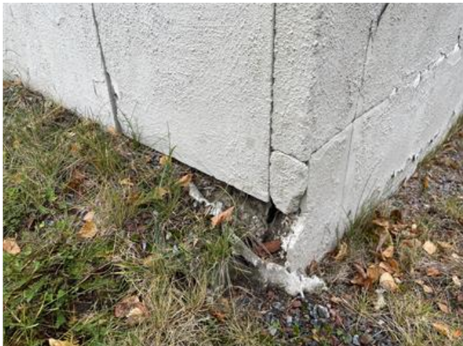
Sprickor förekommer på sockel.
