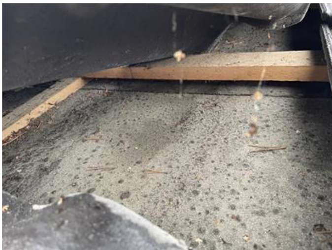
Del av taket har äldre standard och takpappen och takpannornas tekniska livslängd anses vara passerad.
