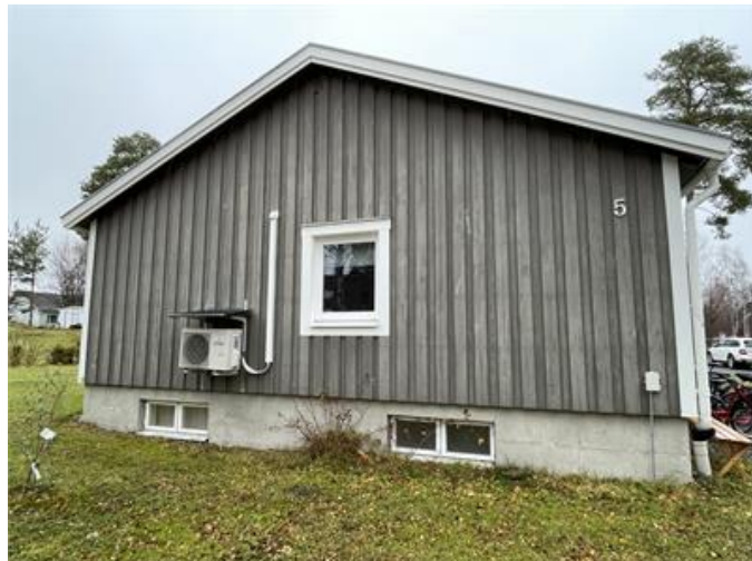
Fasaden har målningsbehov, i huvudsak på solexponerad sida.
