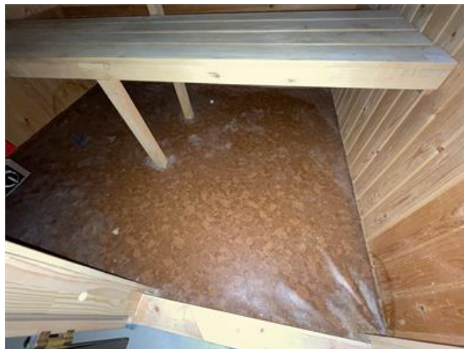
Diffusionstätt golvytskikt bedöms med tanke på rådande fuktighet i underlaget vara ett olämpligt materialval i källaren.
