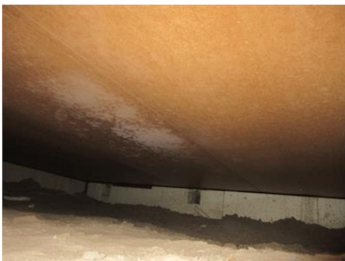
Mikrobiell påväxt på undersida bjälklag i grund
