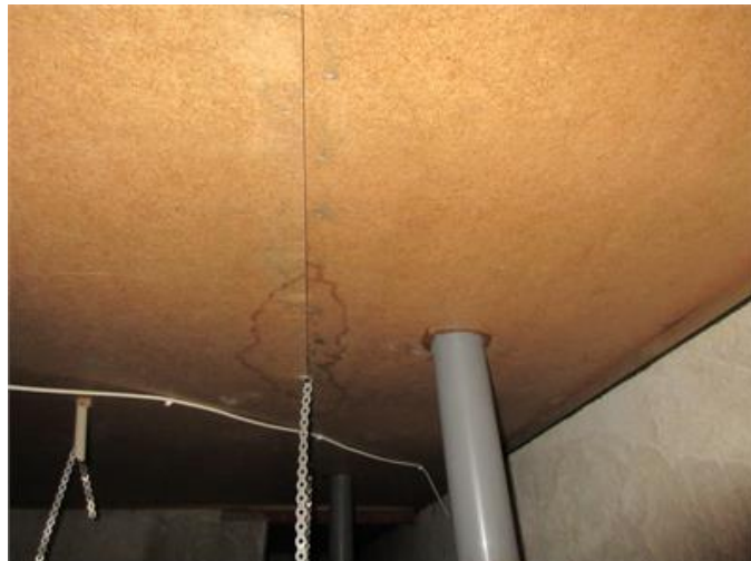
Missfärgning på undersida bjälklag i grund (torr vid besiktningstillfället)
