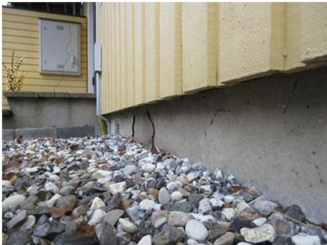
Frostsprängningar i sockel
