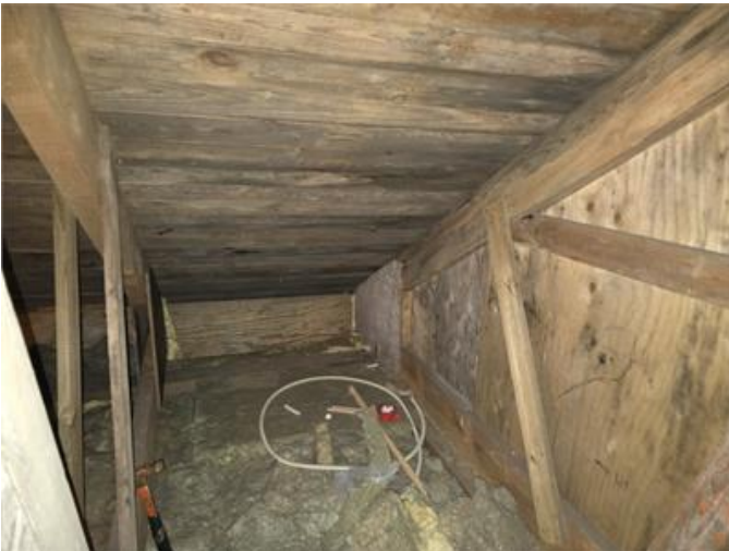
Exempel på del av underlagstak med mikrobiell påväxt.
