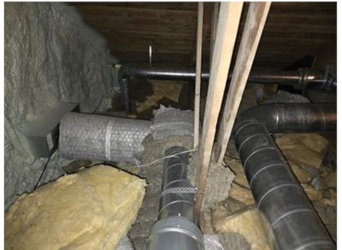
Exempel på del av vind med brister i isolering.
