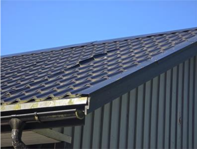
Skarv på plåttak som rest sig.
