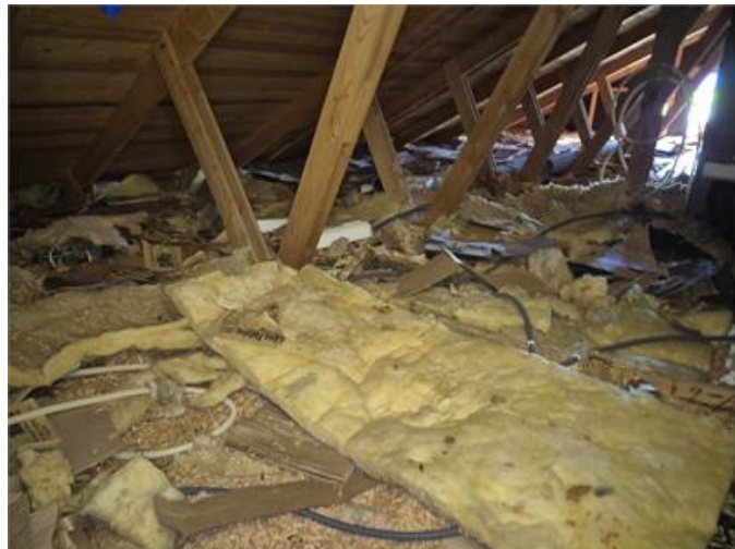
Delar av isoleringen i vindsbjälklaget ligger i olag.
