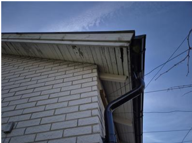
Lokal rötskada i takutsprångsbrädor.
