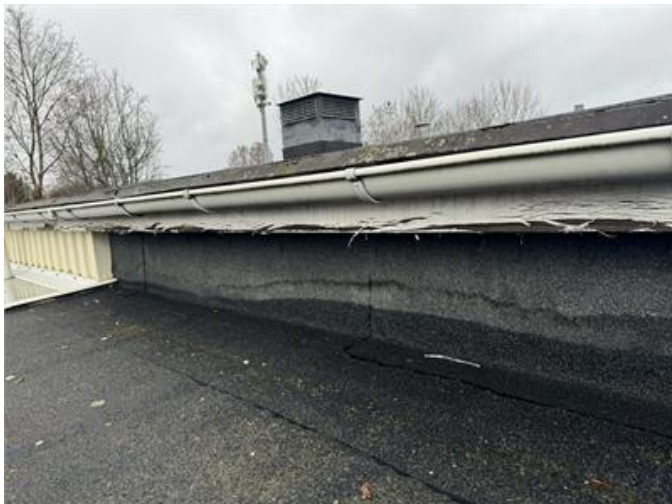
Läckage förekommer vid takfotens insida.
