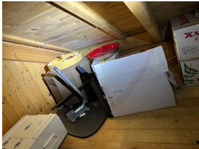
Pos 2. Mikrobiell påväxt förekommer i begränsad omfattning
