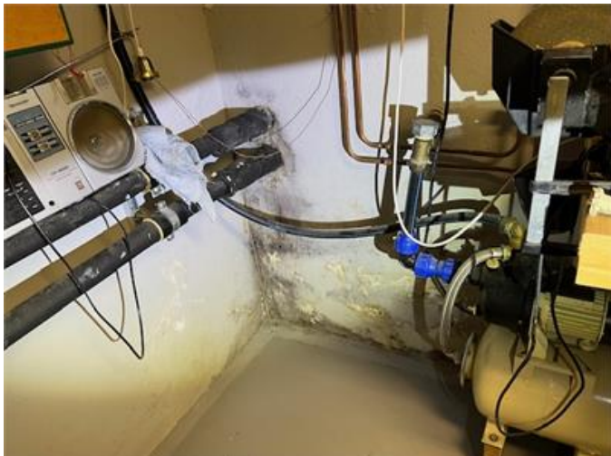
Pos 1. Missfärgningar förekommer på vägg under rörgenomföringar.
