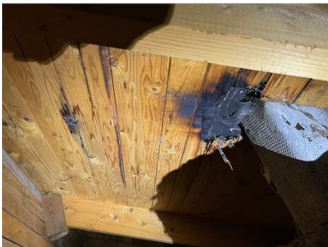
Pos 3. Ventilationsrör från köksfläkten är bristfälligt isolerad och lokala förkolningar förekommer i underlagstak.
