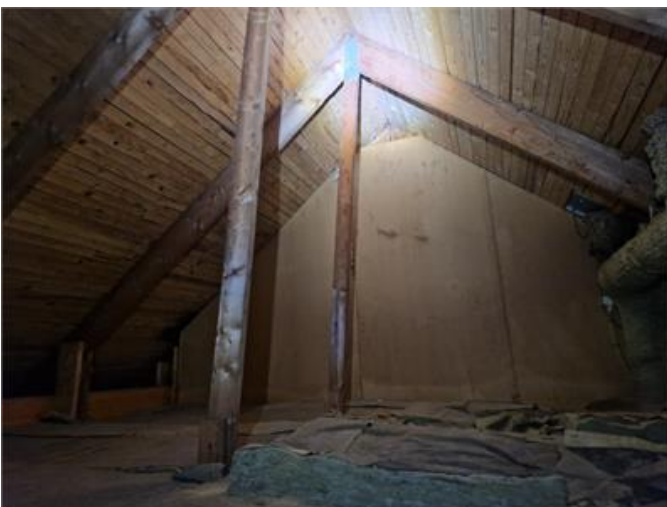
Strävor till takstolar står ej i lod
