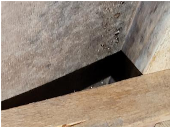
Mikrobiell påväxt samt missfärgningar/fuktfläckar
