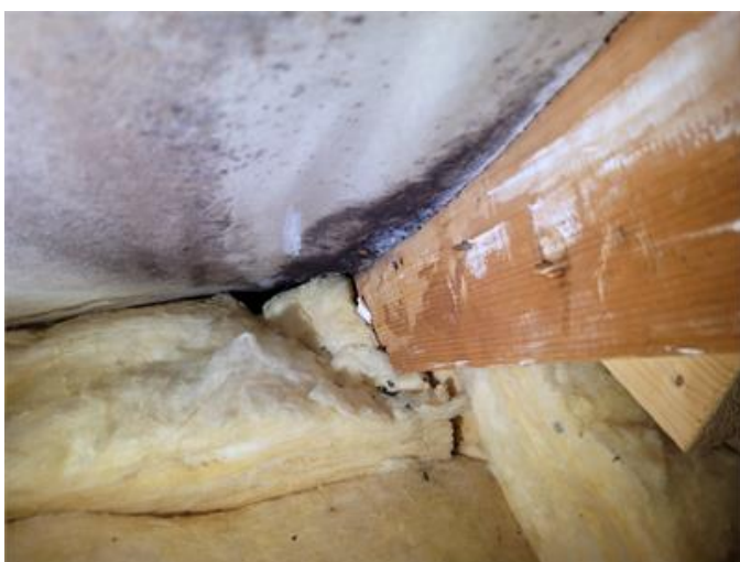
Mikrobiell påväxt samt missfärgningar/fuktfläckar
