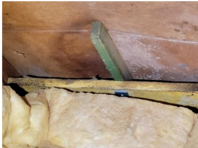
Mikrobiell påväxt samt missfärgningar/fuktfläckar
